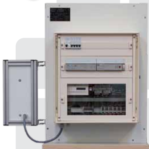
Face arrière du panneau avec son coffret de raccordement
