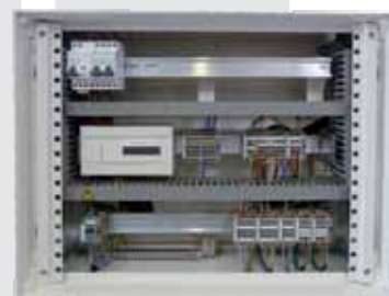
Face arrière du panneau avec son coffret de raccordement.
