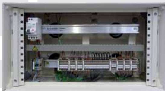
Face arrière du panneau avec son coffret de raccordement.
